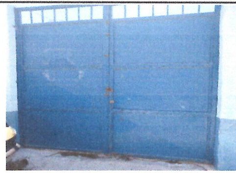
Foto 2: MANTENIMIENTO A PORTON EN MAL ESTADO
