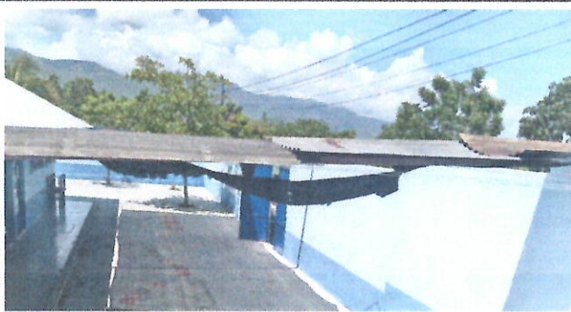
Foto 3: CUBIERTA DE LAMINA EN MAL ESTADO
